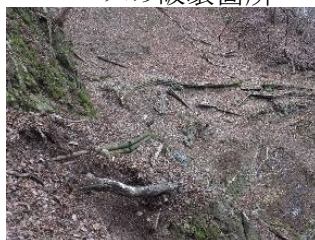
コースの破壊箇所
